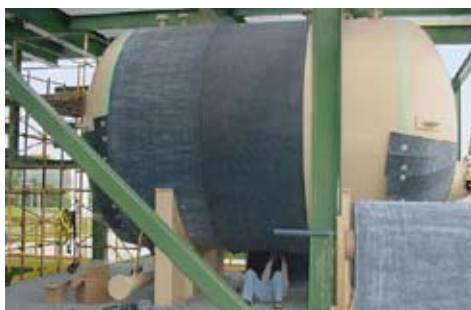
Câmara de 16' x 20': As mantas de aerogel aumentam a produtividade da mão de obra em tanques, torres e câmaras.
